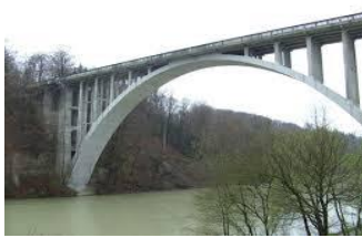
...Risse im Beton...
